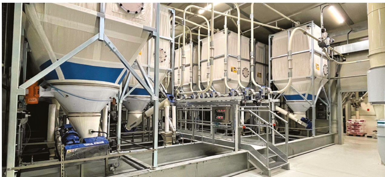
L'impianto realizzato da Ocrim.
